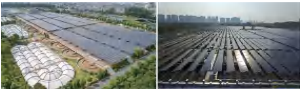
图5 建设污水厂光伏电站提供绿色清洁电能 [25]
